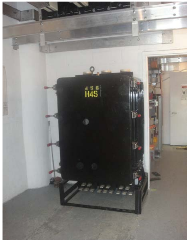
Submersible 460 volt network protector
